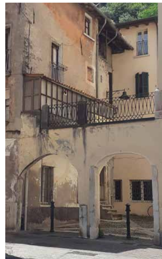
Fig. 37 - La costruzione si trova ancora in uno stato di degrado avanzato.
