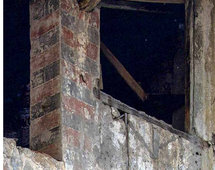
Fig. 15 - Pilastro a fasce rosse e nere. Sotto l'apertura un tamponamento in legno e riempimento di materiale vario(sassi, malta, paglia e legno).
