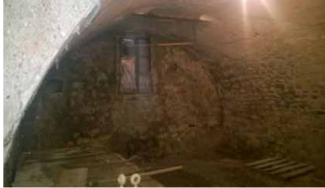
Fig. 52 - Cantina con catene in legno.
