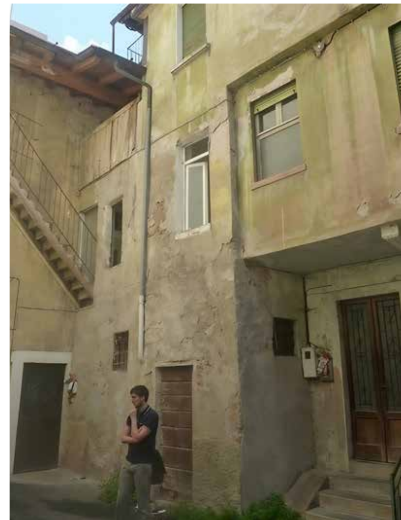
Fig. 31 - Parte retrostante del fabbricato in cui si evidenzia una stratigrafia compositiva moderna (anni '60-'70) e non progettata.
