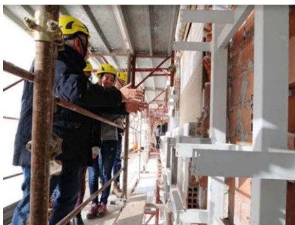
Fig. 1. Brescia: Palazzo in Via Vittorio Emanuele. Illustrazione dei sistemi di ancoraggio della struttura.
