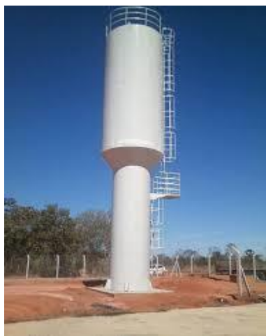
Figura 86. Serbatoio in acciaio
