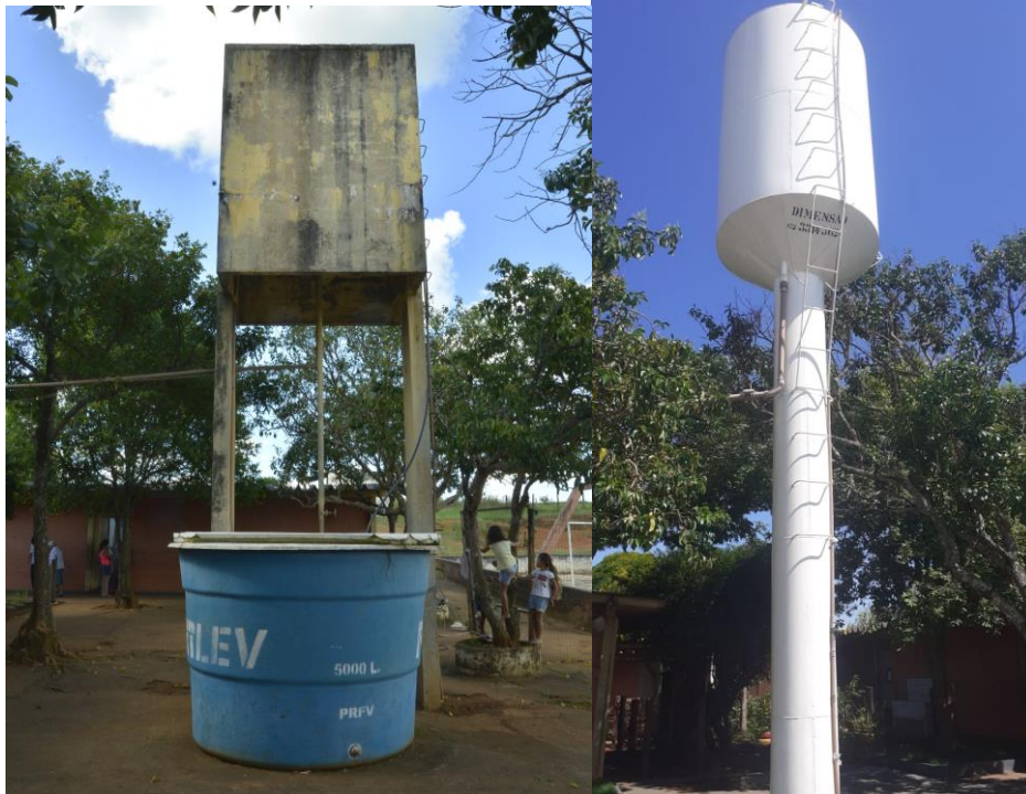
Figura 23. Serbatoio prima e dopo l'intervento WASH. Foto: Leonardo Cairo
