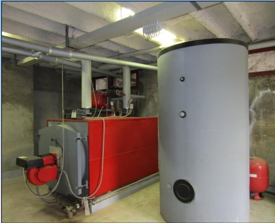
Caldaia a gasolio
