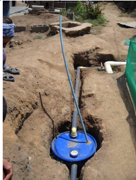
Fig. 4.26: Tubicino di allontanamento biogas
