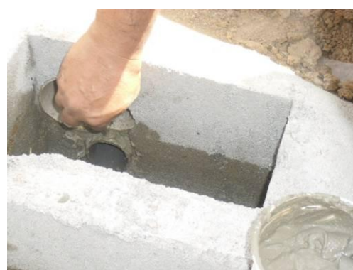
Fig. 4.8: Uscita Trappola e più sopra il tubo di by-pass
