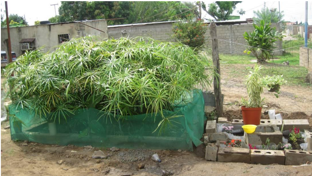
Fig. 4.34: Impianto di fitodepurazione e orticello a valle (costruito ad Settembre 2012)
