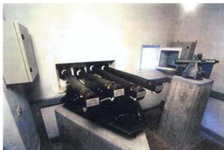
Fig. 3 - Il locale dei collimatori presso la diga di Comelico; sulla sinistra si può osservare l'unità elettronica di controllo, mentre sulla destra è presente un collimatore ottico Galileo.
