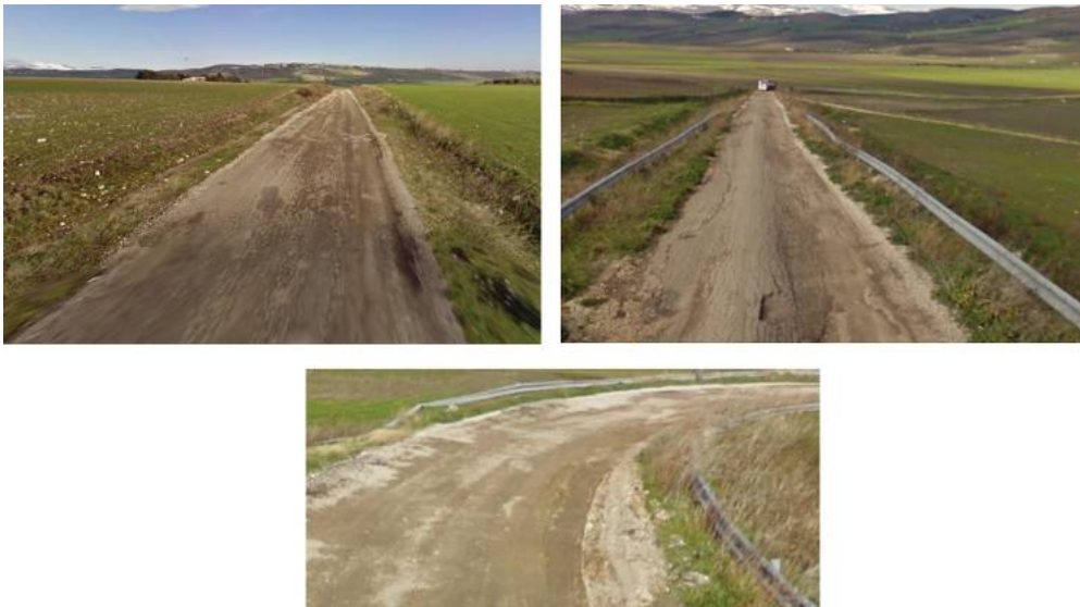
Figura 8.151 Identificazioni delle criticità che presenta la SP111 a livello di sezione stradale e stato manutentivo della pavimentazione stradale.
