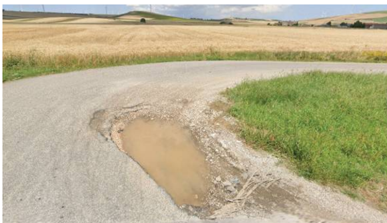
Figura 8.153 Identificazione delle criticità al transito dei veicoli lungo l'intersezione tra la SP109 e la SP112.
