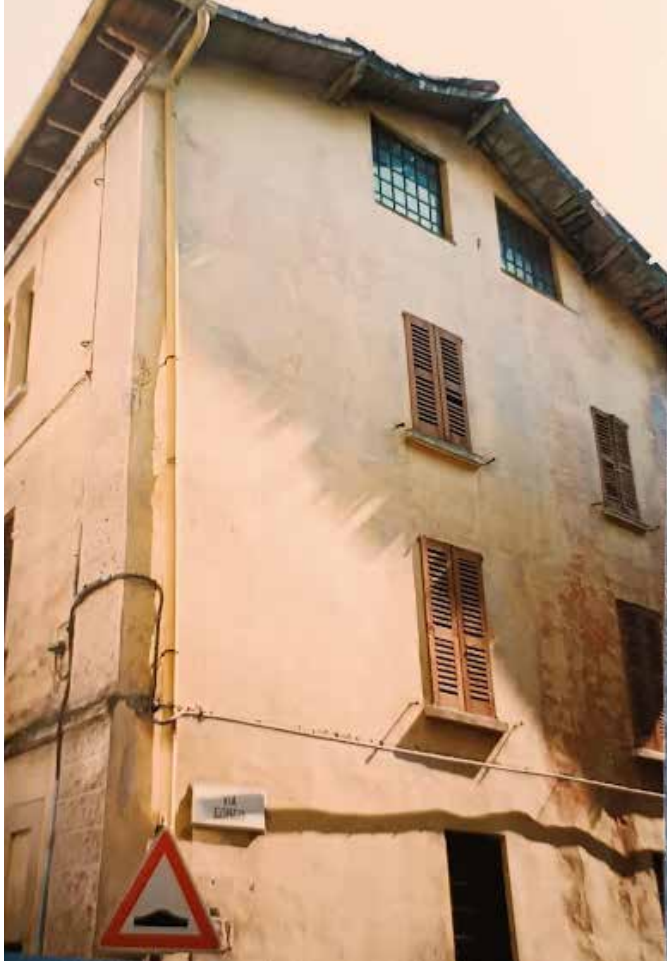
Fig 11 - esempi di edificio con richiesta di modifica di classificazione all'interno dello strumento urbanistico.
