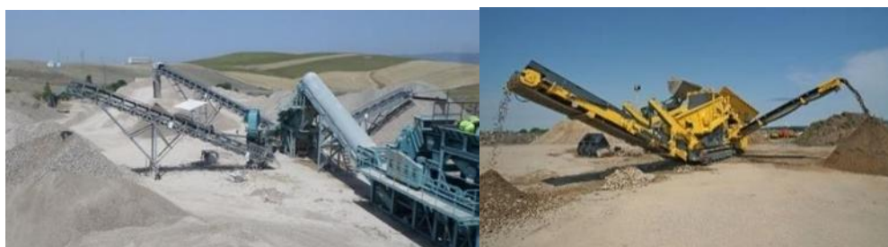
Figura 3.3 - Impianto di trattamento fisso (sinistra) e impianto di trattamento mobile (destra) [68]
