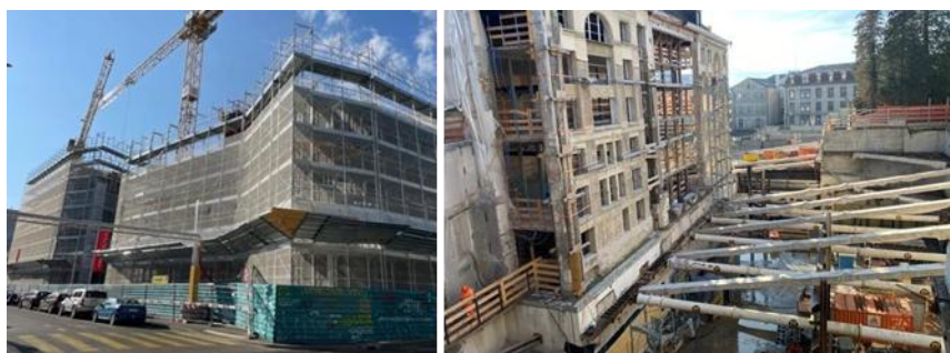
Figura 3.11 - Ricostruzione di un edificio a Ginevra (sinistra) e dell'Università di Friburgo (destra)
