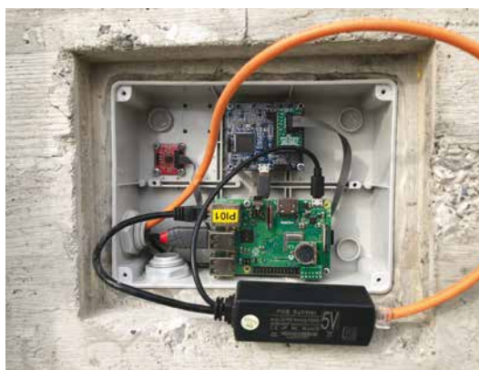
4. La sensoristica per la misura, l'elaborazione e la trasmissione dei dati installata sull'impalcato del ponte pilota di Bassano Bresciano (BS)
